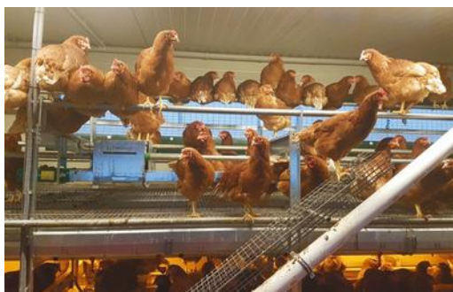
Vollautomatisches Lüftungs- und Lichtregelsystem
