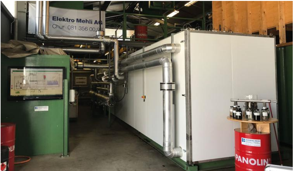
Die HTC-Anlage im Betrieb.
